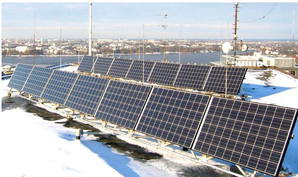
Bild 1: Erneuerte PV-Anlage auf dem Dach des Hochhaus- es Berliner Tor 7 mit Blick auf die Außenalster
