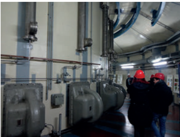
Besichtigung Im Gang rund um den Reaktorkern tief unten im Betonblock
