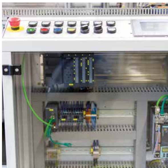
Unterbauschrank mit Steuerung und Buskomponenten
